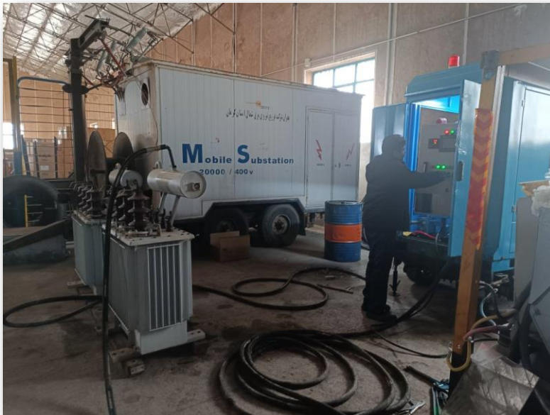
راه اندازی دستگاه تصفیه روغن ترانس
