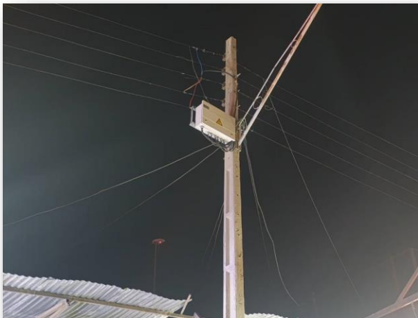
نصب ۳۰ تابلو جهت ۱۴۶ واحد تجاری
